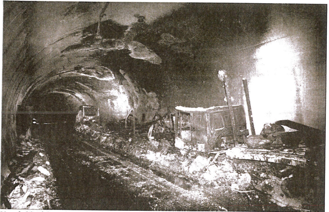
Vue de l'intérieur du tunnel du Mont-Blanc après la catastrophe. Le 24 mars 1999, l'incendie d'un camion y provoquait la mort de 39 personnes.
